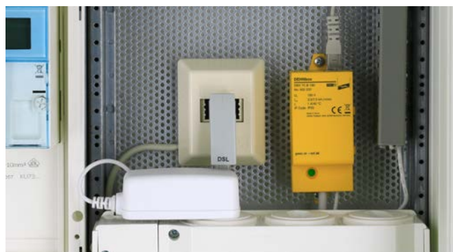
DEHNbox dans la zone de raccordement de télécommunication (exemple : interface U_{k0} )
