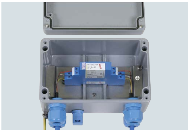
Parafoudre universel multipolaire débrochable pour systèmes à sécurité intrinsèque avec surveillance LifeCheck.
